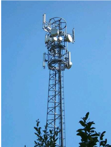
Zdjęcie 13. Stacja przekaźnikowa
